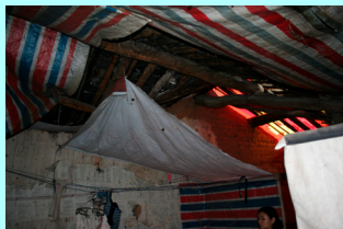
De bovenverdieping na de brand in 2010.
