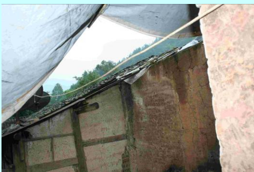
Stuk weggeslagen dak, aan de achterzijde van het huis.
